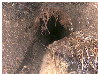
Wurzeleinwuchs an undichter Rohrverbindung
