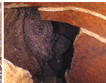
Fehlendes Rohrstück, Hohlraum sichtbar
