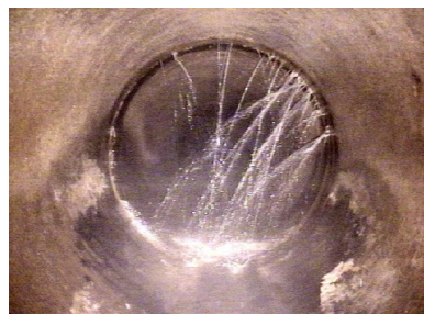
Undichte Rohrverbindung, Wasserzutritt
